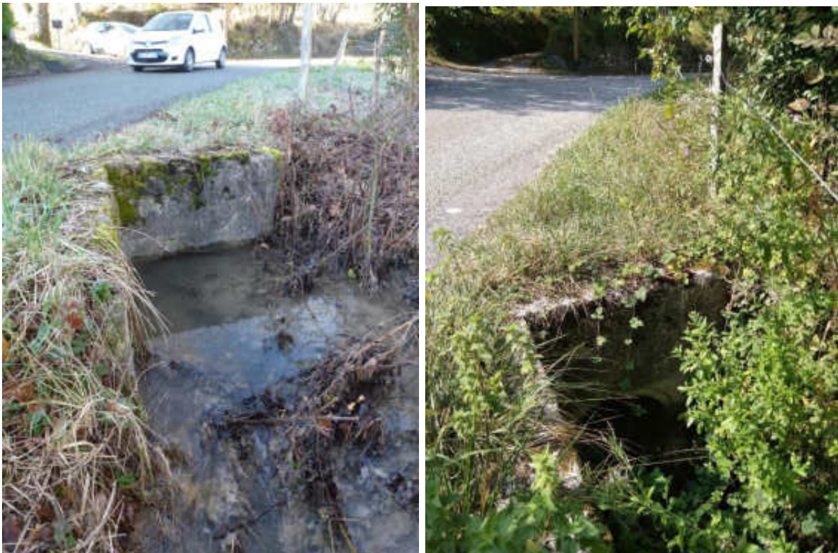
Figure 17 : exutoire de la buse sous la RD23 obstrué (à gauche, février 2020) et en fonctionnement normal (à droite, septembre 2020)
