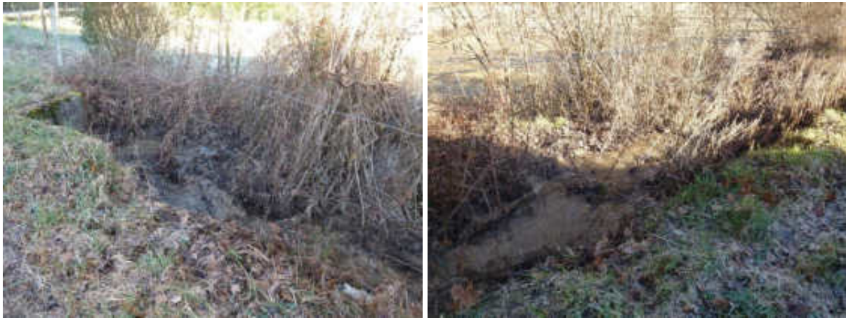
Figure 25 : exhaussement et débordement du fossé en février 2020 à cause du dépôt de fines en sortie de l'ouvrage busé sous la RD23
