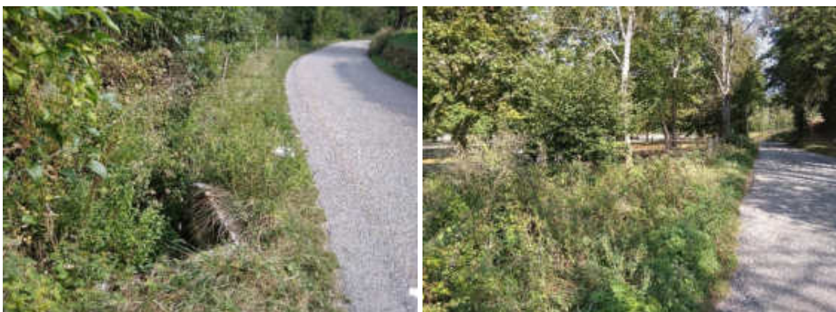
Figure 10 : fossé « perché » encombré entre la sortie de l'ouvrage sous la RD23 et le parking du Parc de la Préhistoire
